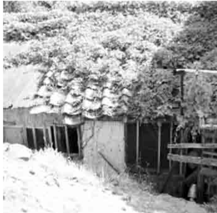
老朽した空き家(本年度は11戸解体予定)
